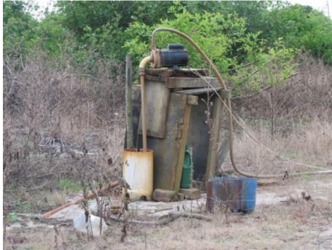
Figura 18 - Bomba de poço em Gameleira.
