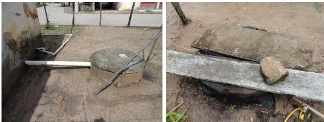
Figura 4-24: Fossa residencial em Nativo
