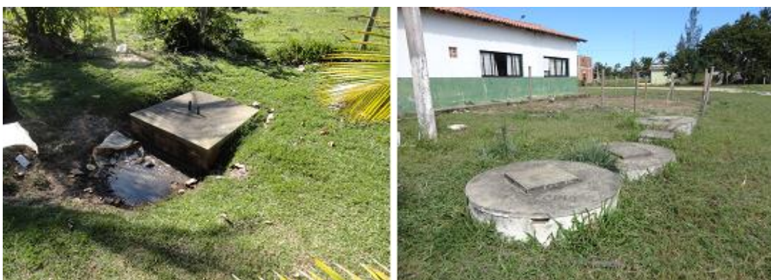
Figura 4-23: Fossa residencial e na escola em Campo Grande
