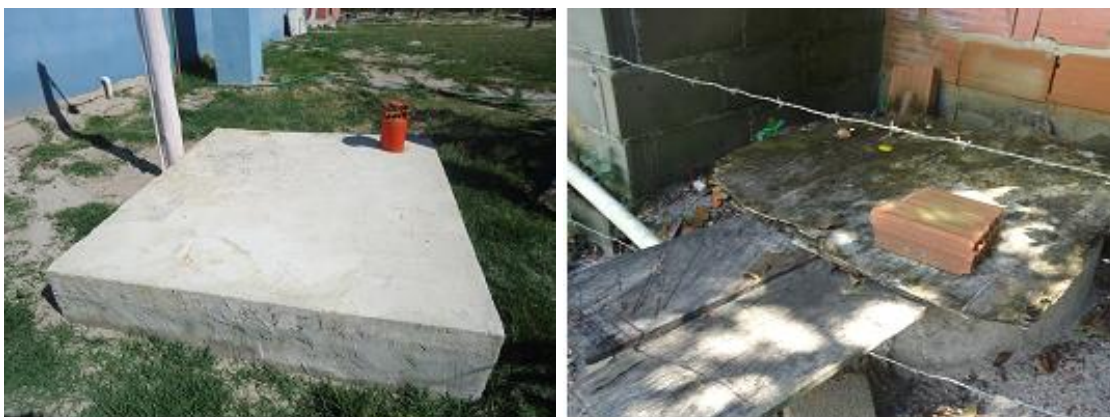
Figura 4-22: Fossa residencial em Barra Nova Sul
