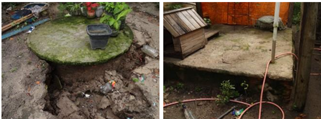
Figura 4-25: Fossa residencial em Nativo
