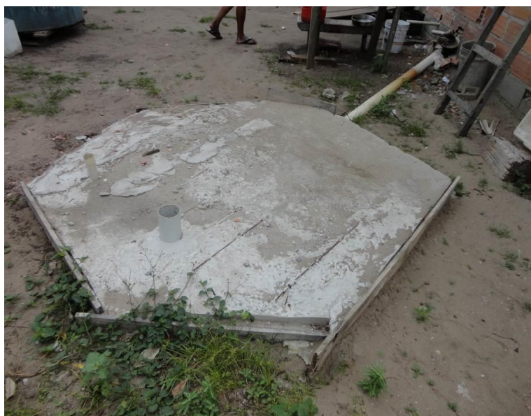
Figura 3-52: Fossa séptica – Barra Nova Norte
