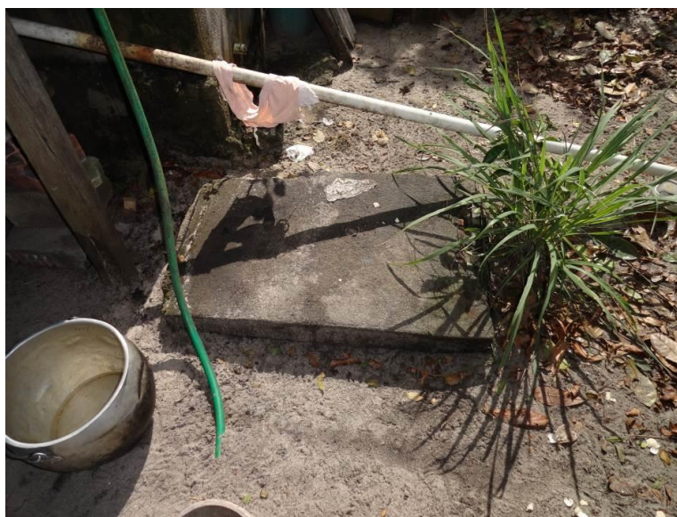
Figura 3-56: Fossa séptica – Campo Grande
