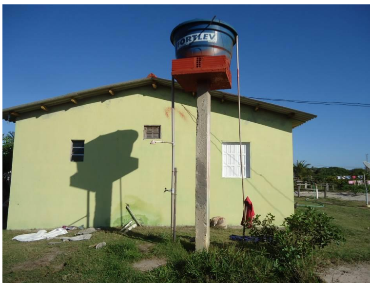
Figura 3-38: Caixa d'água residencial – Campo grande.
