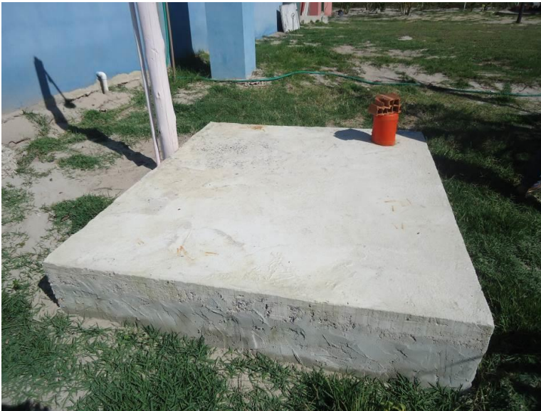
Figura 3-54: Fossa séptica – Barra Nova Sul
