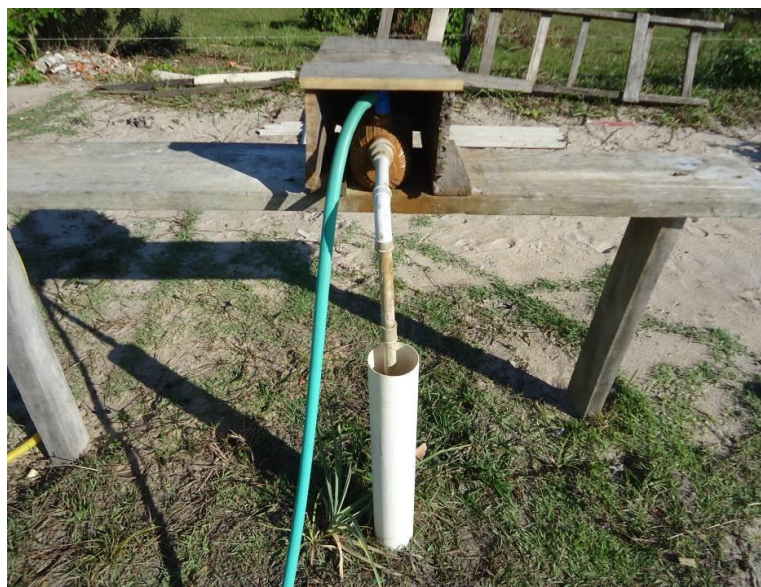
Figura 3-37: Poço/Bomba– Campo Grande
