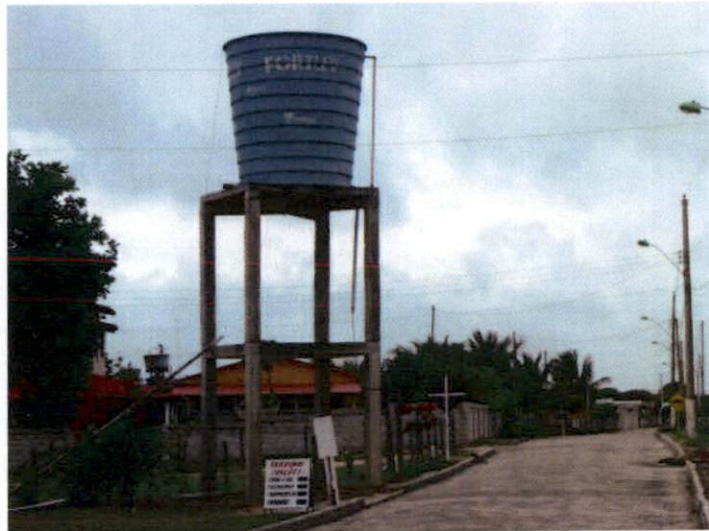
Figura 17 - Caixa de água na Comunidade e Barra Nova Sul, sem funcionamento.
