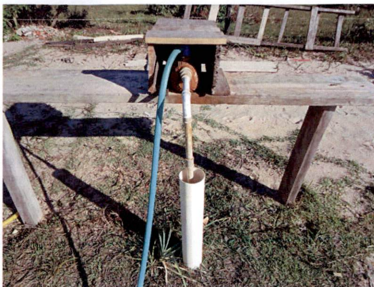
Figura 3-37: Poço/Bomba– Campo Grande
