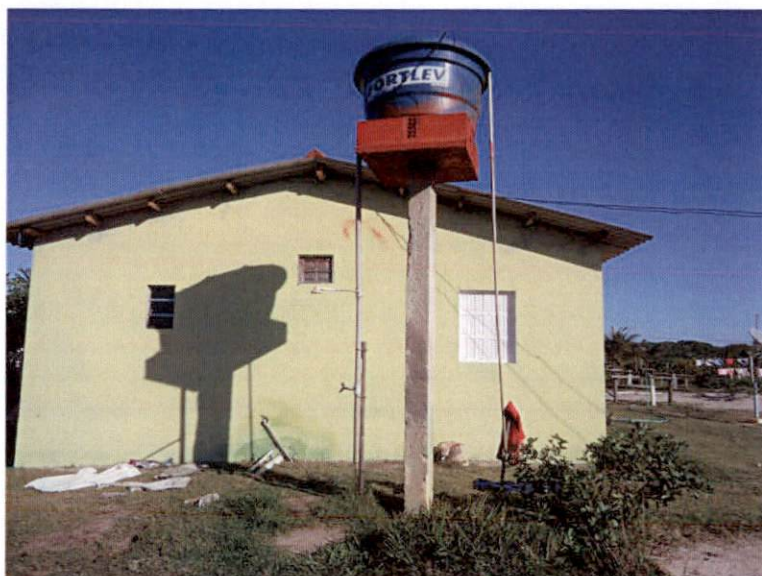
Figura 3-38: Caixa d'água residencial – Campo grande.
