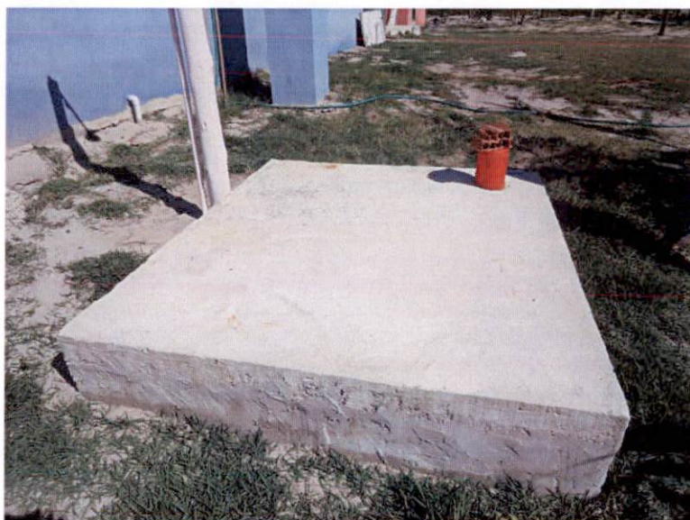
Figura 3-54: Fossa séptica – Barra Nova Sul
