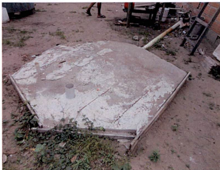
Figura 3-52: Fossa séptica – Barra Nova Norte
