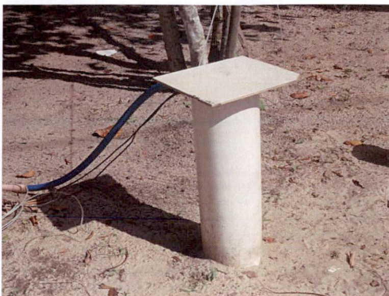
Figura 3-35: Poço/Bomba– Barra Nova Sul
