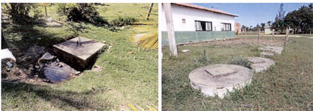
Figura 4-23: Fossa residencial e na escola em Campo Grande
