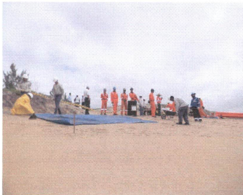
Barreiras de contenção Praia Urussuquara
