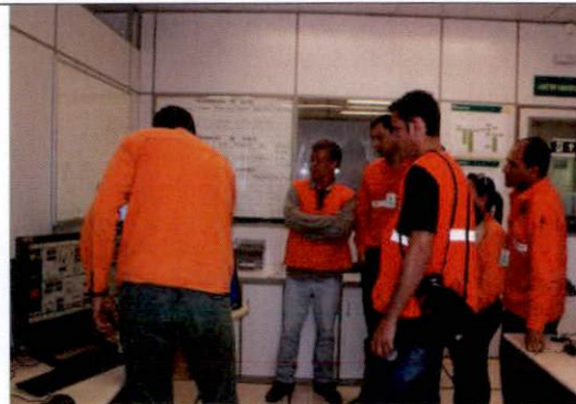
SALA DE CONTROLE
