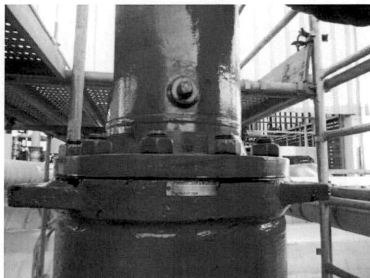
Figura 4 - Válvula após limpeza.
