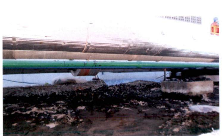
Limpeza já iniciada. Demonstração da dificuldade de acesso a área.
