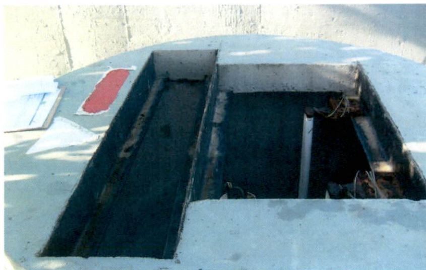
Figura 7 - Coleta na entrada da Estação de Tratamento de Efluentes do TNC (Elevatória)
