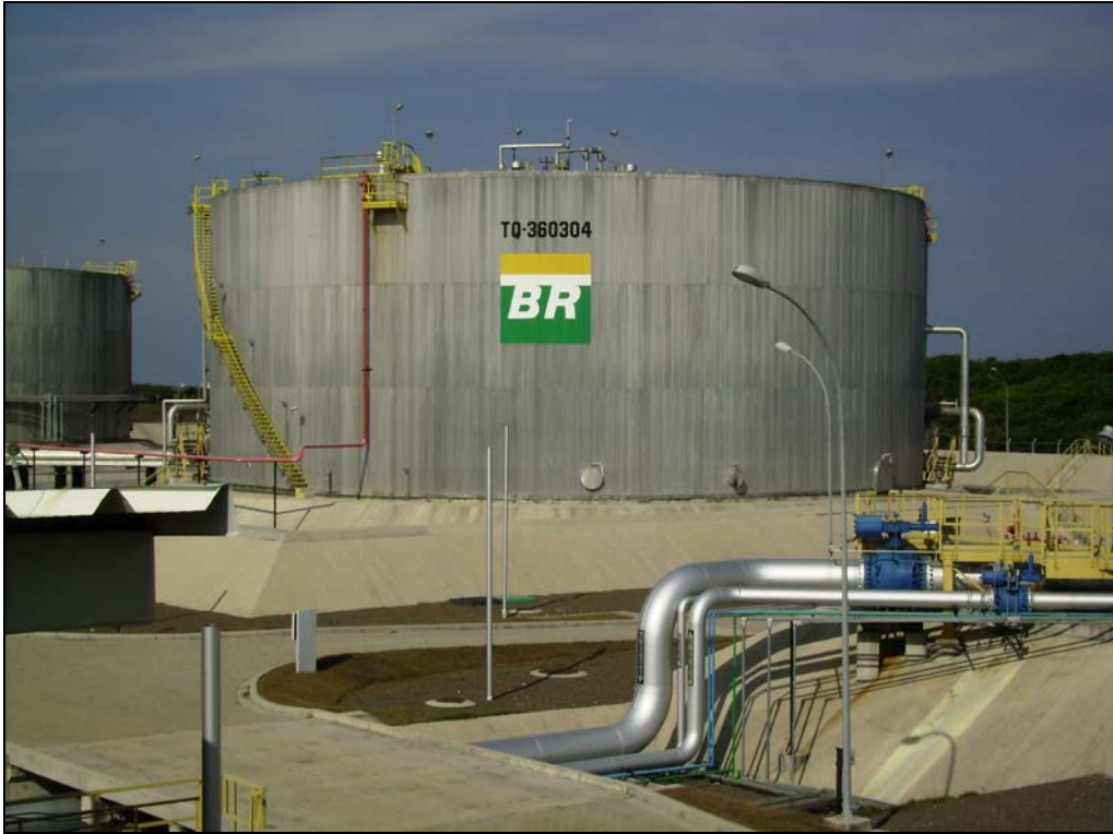
Foto 5 – Tanque de teto fixo
