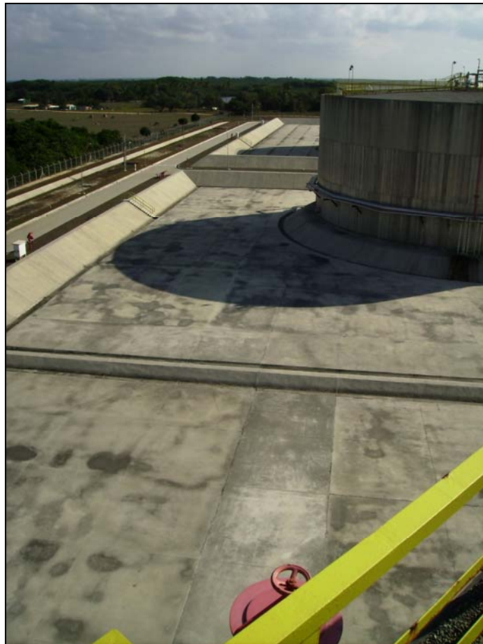
Foto 6 – Bacia de contenção dos tanques
