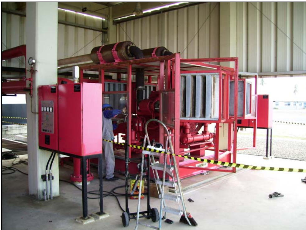
Foto 14 – Bomba de incêndio
