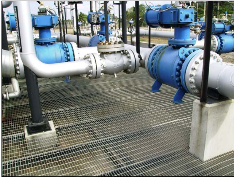
Foto 3 – Válvula SDV no scraper de entrada
