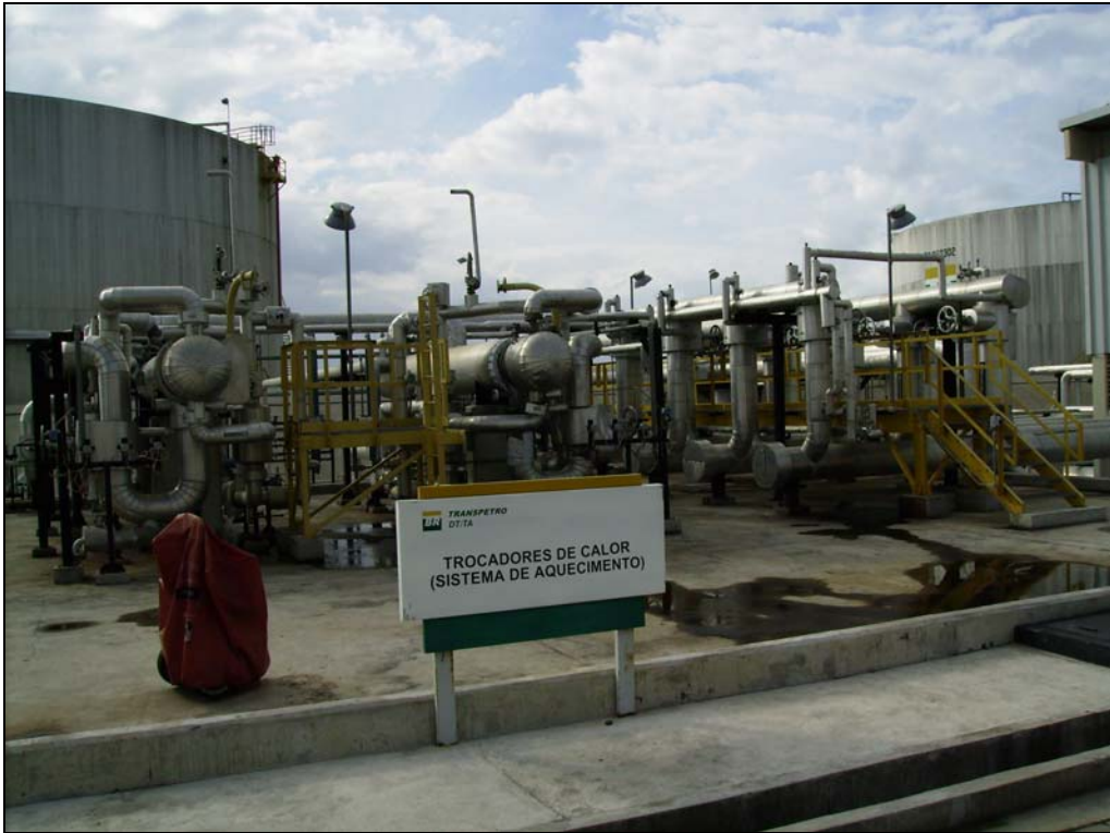
Foto 11 – Trocadores de calor
