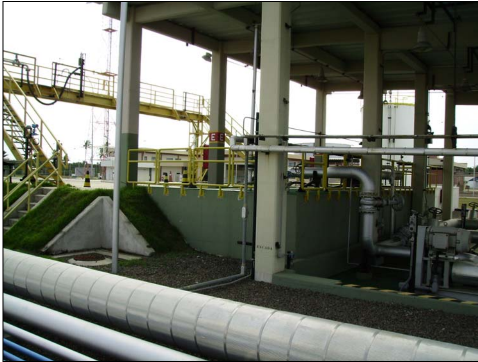
Foto 7 – Plataforma de descarregamento de caminhões-tanque
