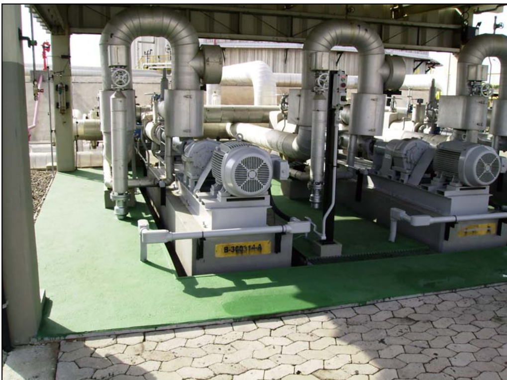
Foto 12 – Sistema de recirculação de óleo
