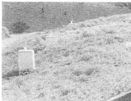
Sistema de selagem dos drenos de biogás para o re aproveitamento
