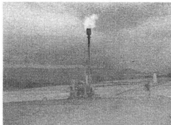
Queima do biogás através de Flare
