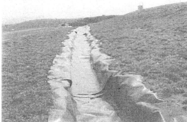
Sistema de drenagem superficial utilizando-se manta de PEAD
