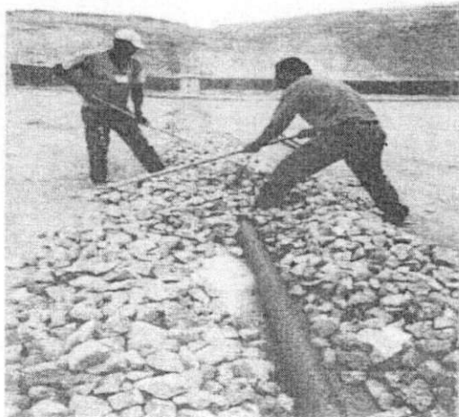
Drenagem dos líquidos percolados
