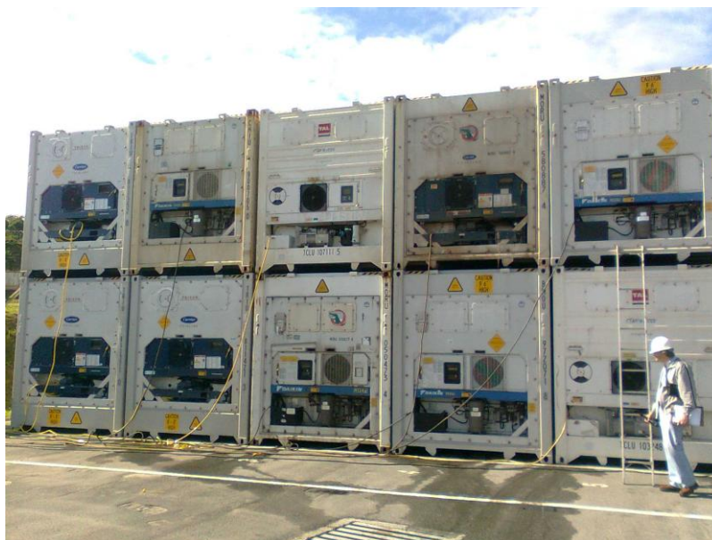
Figura 5.30 – Ilustração de contêineres refrigerados armazenados no píer
