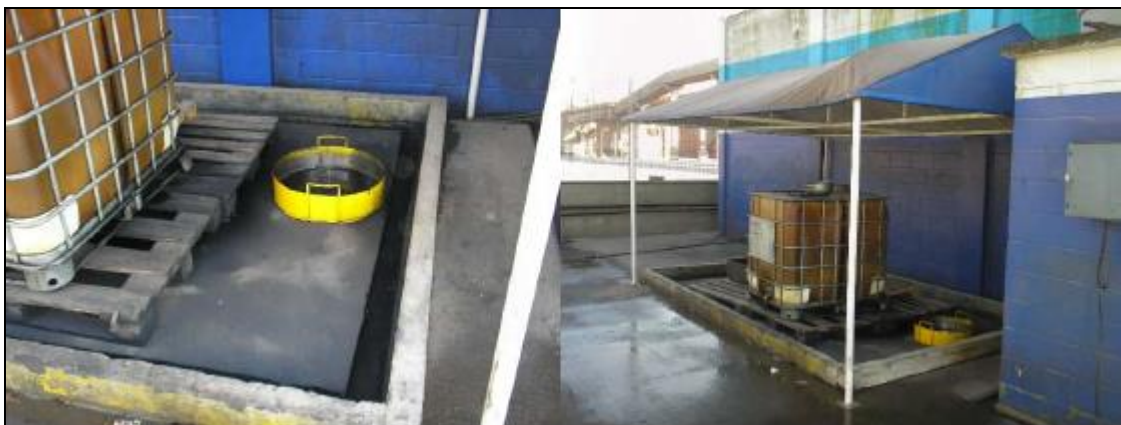
Figura 12. Central de Armazenamento de Óleo Lubrificante Usado.
