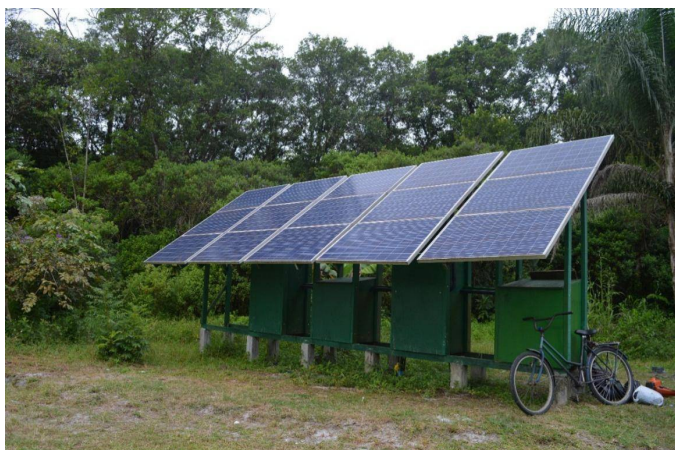
Figura 99 Painéis de energia solar na TI Sambaqui. Tekoa Karaguata Poty.
