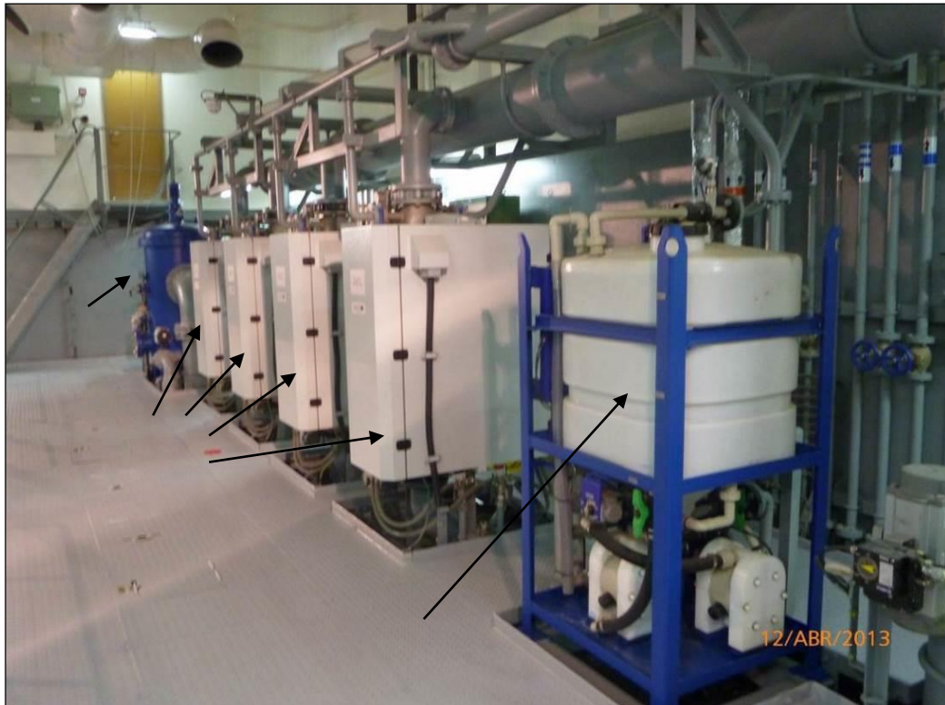
Figura 16. Sistema de tratamento de água de lastro instalado a bordo. Fonte: ACQUAPLAN (2013).
