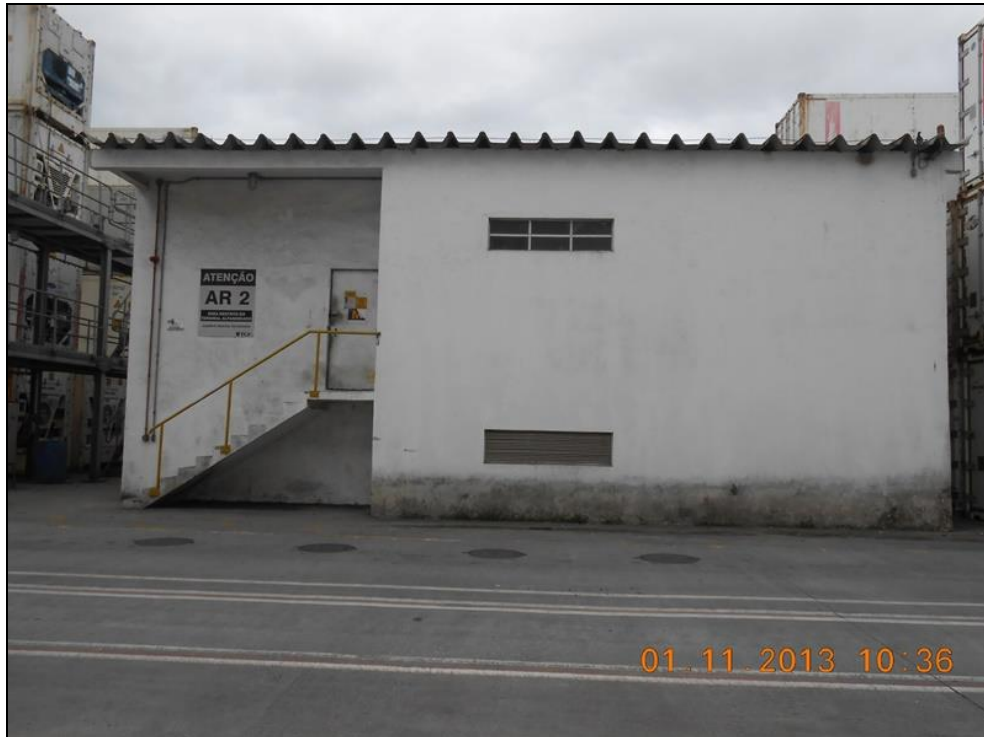
Figura 24. Subestação Transformadora ST2.
