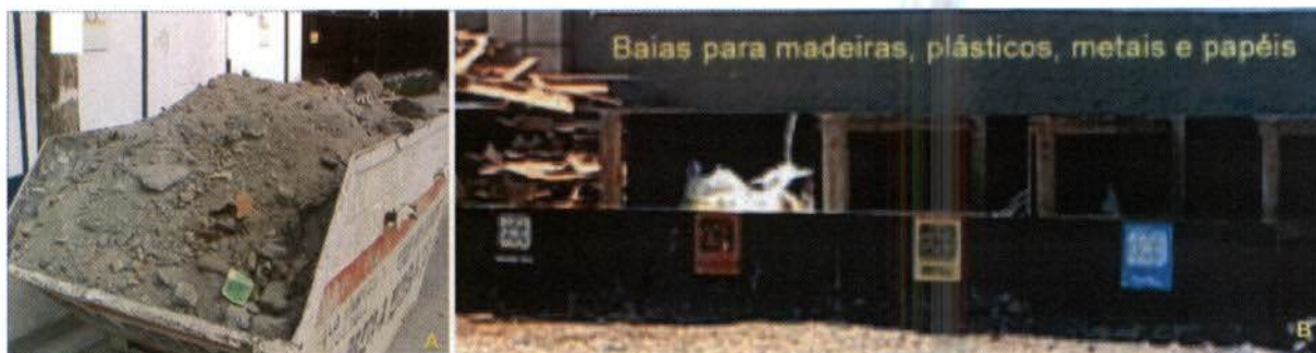
Figura 30: Formas de acondicionamento final de resíduos de construção: A (Caçamba estacionária) e B (baías).
