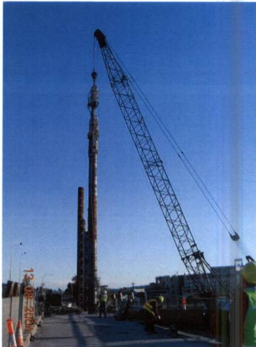
Figura 28: Ilustração de sistema de cravação de estaca com utilização de martelo vibratório.
