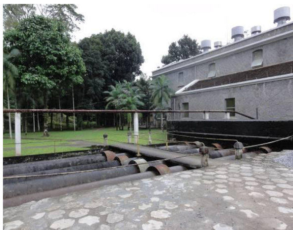
Figura 5.3.1.12-3: Tubulação de água.
