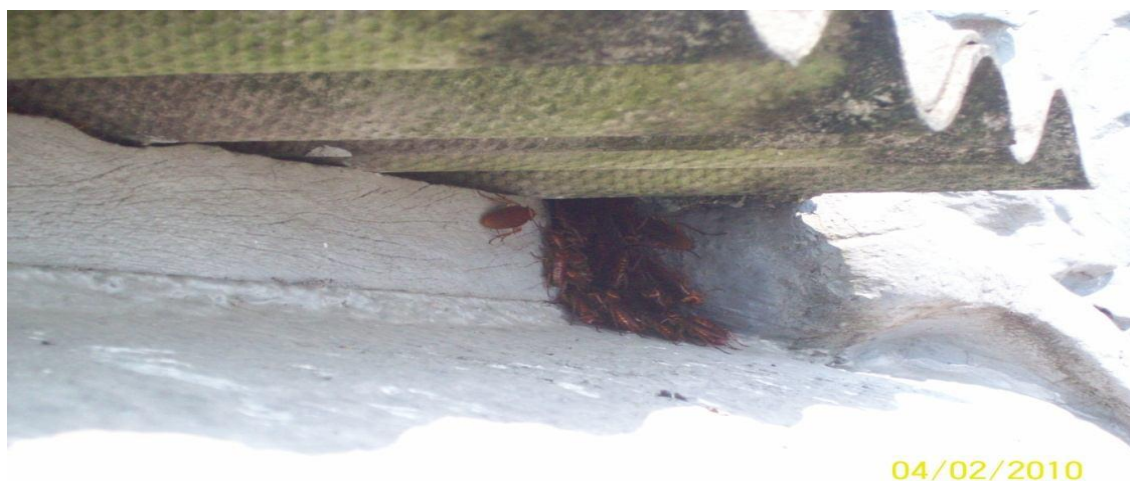
Figura 4.2.6.8.6-3: Colônia de baratas P. americana - telhado da Dirop (Fonte: LSI Assessoria e Consultoria, 2010).
