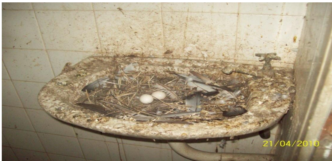
Figura 4.2.6.8.1-20: Situação identificada pela empresa LSI Assessoria e Consultoria - fundos do UFO 3 (Fonte: LSI Asses. e Consultoria, 2010).
