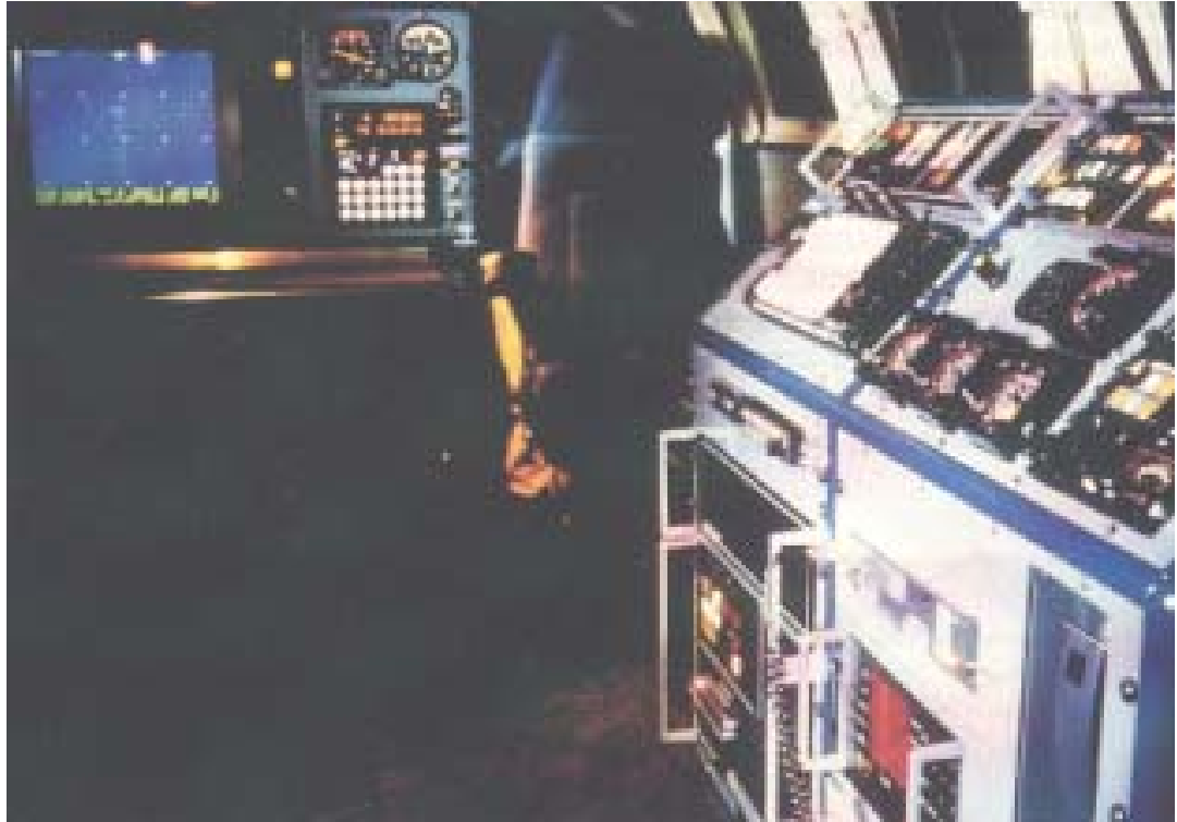
Equipamento de Detecção Remota
