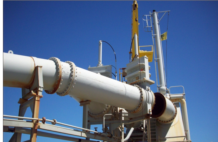
Foto 4: Sistema de recalque de material pela proa desativado.
