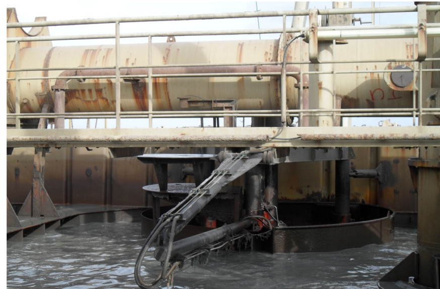
Foto II.2: Sistema de overflow em posição elevada.
