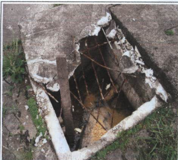
FOTO 07: Resíduos de milho dentro do bueiro de águas pluviais.
