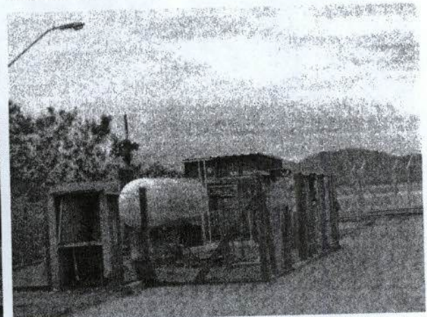
Figura 49 – Tanque de armazenamento de GLP
