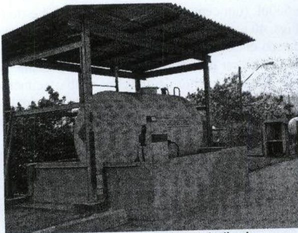
Figura 46 – Tanque de armazenamento de diesel
