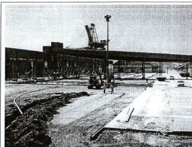
Figura 11: implantação de obras de troca e manutenção do pátio e estruturas de drenagem pluvial no interior do porto sem conhecimento do IBAMA. (UTM 22J 748731 / 7177143)
