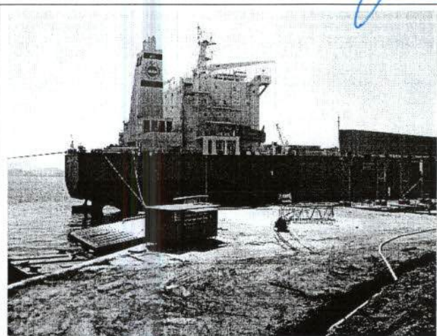
Figura 12: área com obras no cais oeste, como na figura anterior, com visão do cais em utilização. (UTM 22J 748731 / 7177143)
