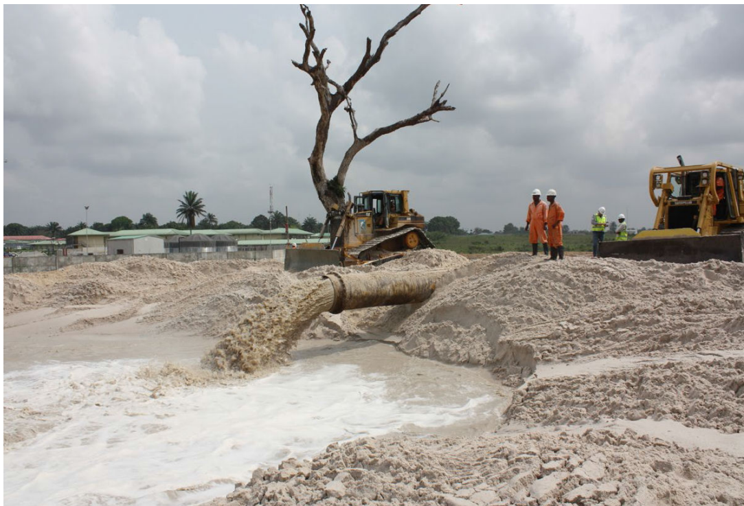
Figura 4.16 - Lançamento dos sedimentos na área de deposição, com espalhamento através de bulldozer
