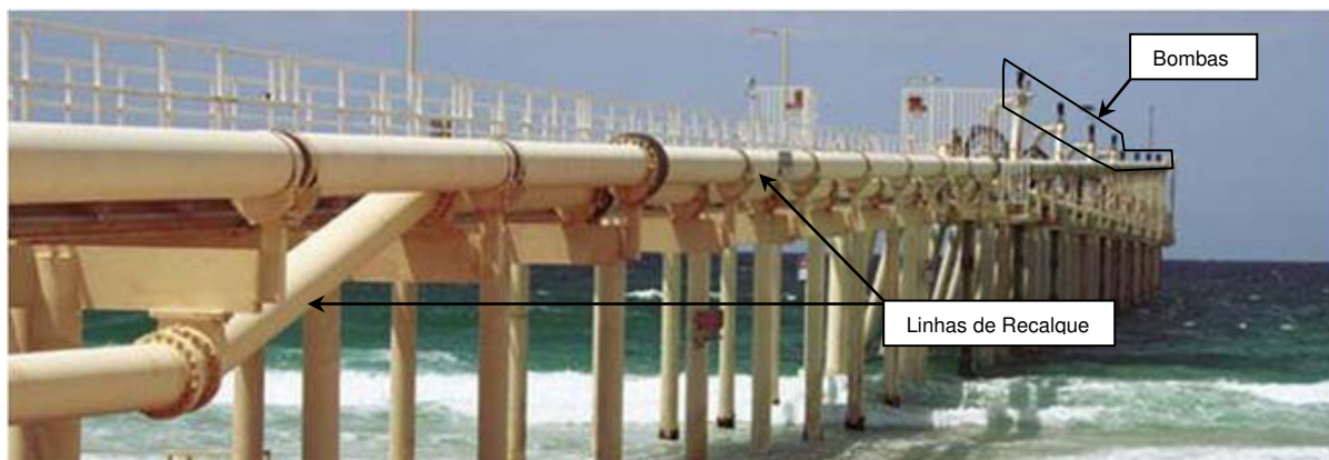
Figura 3.3 - Estrutura fixa para o sistema de bombas de sucção e linha de recalque
