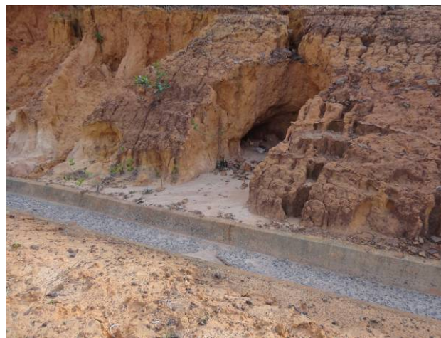
Figura 4.14- Erosão em talude de corte protegido por canaleta de drenagem
