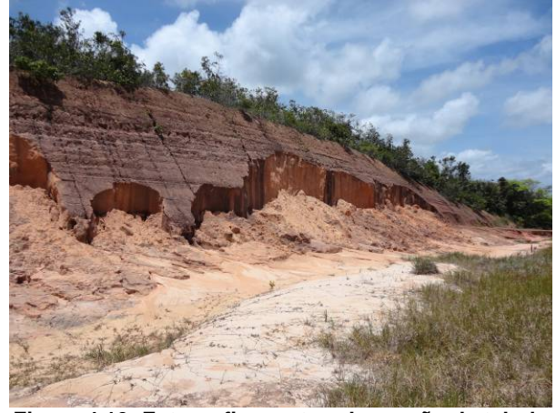
Figura 4.10- Fotografia mostrando erosão de talude por remoção de massa com movimento rápido tipo deslizamento
