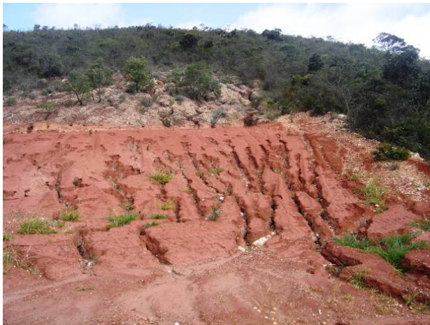
Figura 4.11- Cicatrizes de erosão em um talude de corte de estrada
