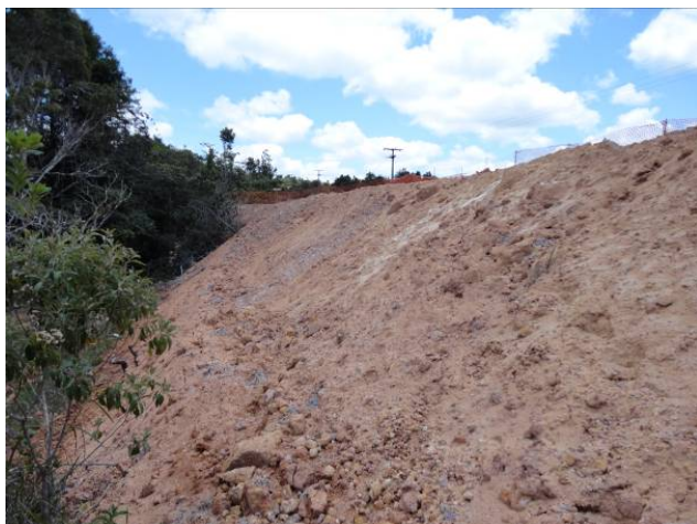
Figura 4.13- Talude de aterro com material desagregado desprotegido, suscetível a erosão
