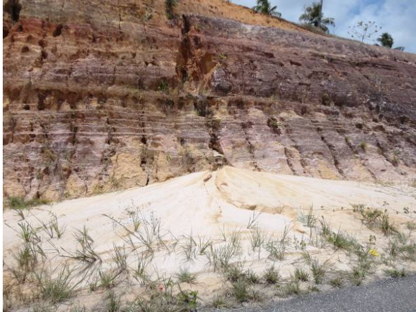
Figura 4.9- Fotografia mostrando erosão do talude por escoamento concentrado, formando ravinas e cone de dejeção de sedimentos
