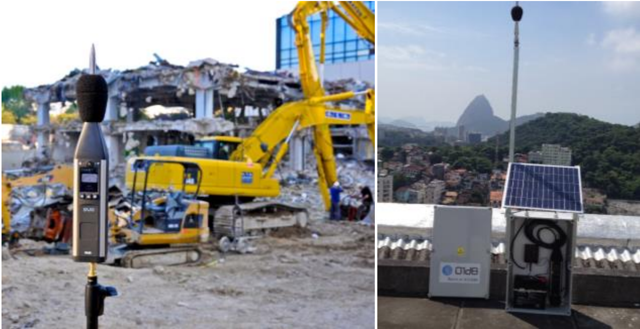
Figura 4.11- Exemplos de Estações de Monitoramento de Ruído: normal (esquerda) e com gabinete com painel solar (direita)
