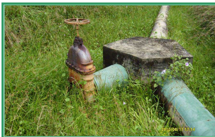
Foto 4 – Detalhe da derivação da tomada
