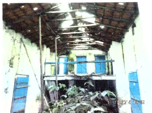
Fig.7 - Vista do estado de arruinamento interior
