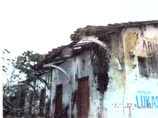
Fig. 4- Vista do Beiral em ruína.
