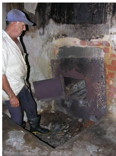
Figura 8.3.5.2.90 - Local onde é Inserida a Madeira que Alimenta o Forno
