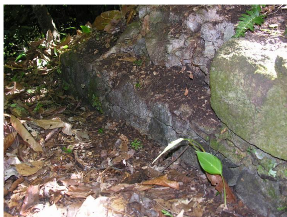
Figura 8.3.5.2.83 - Ruínas do Engenho de Cana de Açúcar, em Alvenaria de Pedra e Cal
