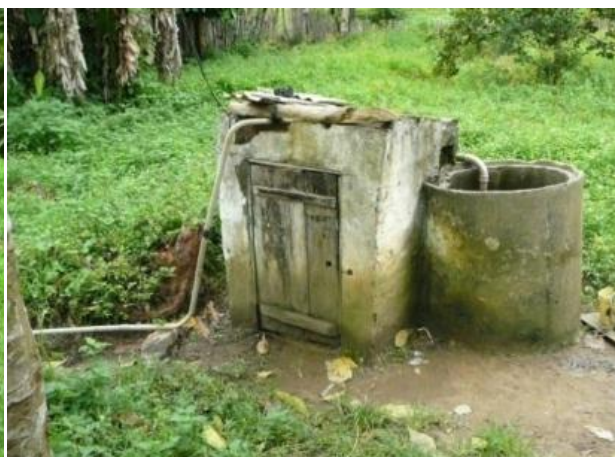
Figura 8.3.2.8.8 - Sistema de Abastecimento de Água
