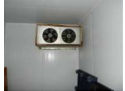
Equipamento de frio subutilizado devido a erro na avaliação da produção para o local
