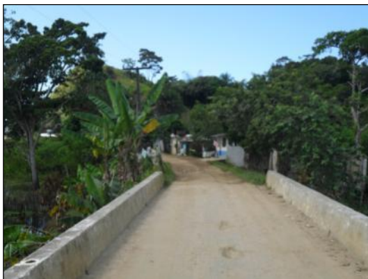
Figura 2.60 - Ponte Sobre Rio Tiriri Situada a Jusante da Estação C03. Próximo à Vila de Urucutuca (Período Chuvoso)
