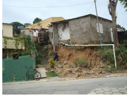
Figura 5.3.4.2.1-9: Rua Topolândia, no bairro Olaria. (Fonte: vistoria SAU)
