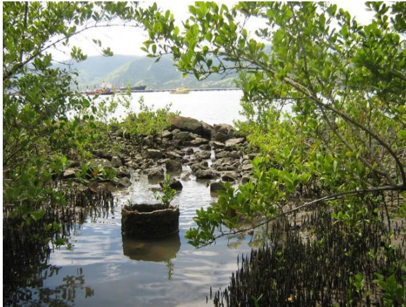
Figura 5.2.1.1.4-16: Canal formado entre brechas das rochas no enrocamento, através do qual penetra a água salgada do mar, pela movimentação das marés.
