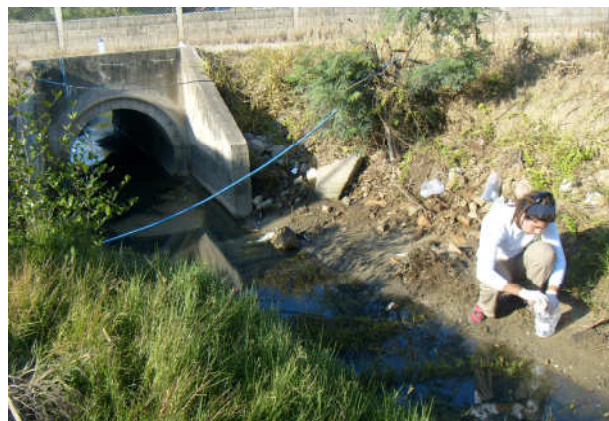
Figura 3 - Amostragem no ponto PA-2, mostrando a tubulação que liga o córrego ao corpo de água marinho.
