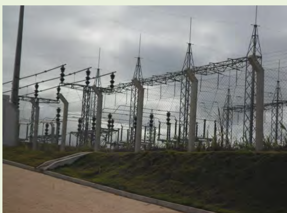
Figura 7.3.1.2.1-267: Estação de Distribuição de Energia - ETD Canivete
