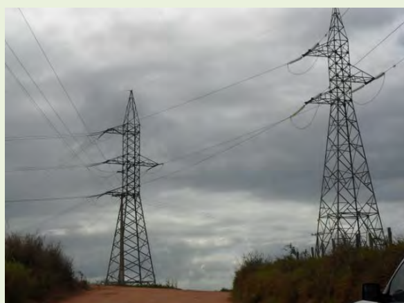
Figura 7.3.1.2.1-268: Estação de Distribuição de Energia - ETD Canivete
