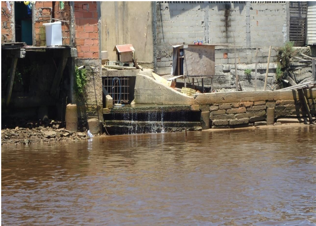
Figura 4.1-76 – Forte degradação antrópica registrada no PD 01
