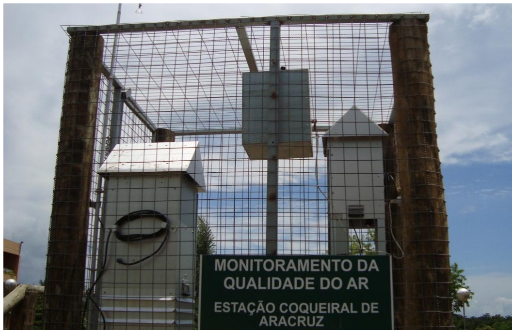
Figura 4.1-38 - Estação de Monitoramento – Unidade Coqueiral
