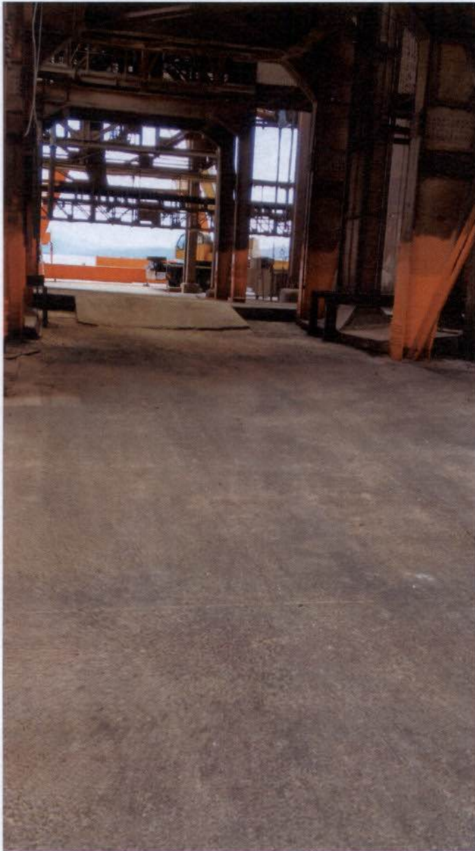
Figura 22: Parte mais antiga do porto onde observa-se acúmulo de resíduos de granéis sólidos.
