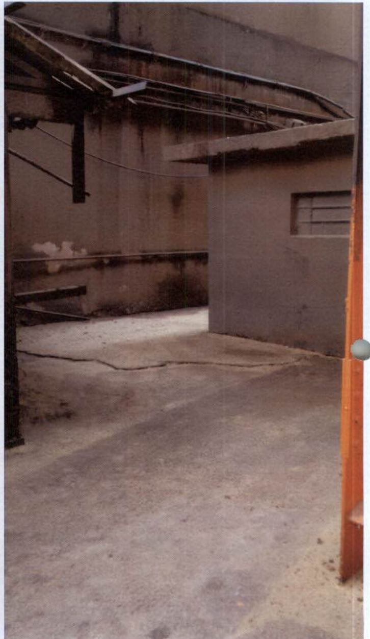
Figura 23: Parte mais antiga do porto onde observa-se acúmulo de resíduos de granéis sólidos.
