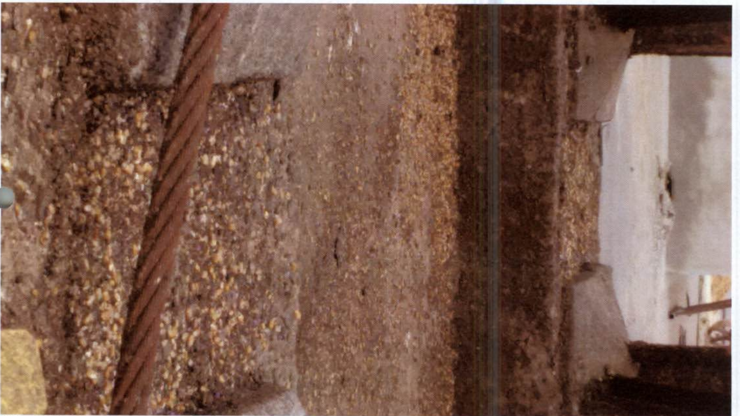
Figura 17: Locais com acúmulo de resíduos, inacessíveis aos carrinhos de varrição.
