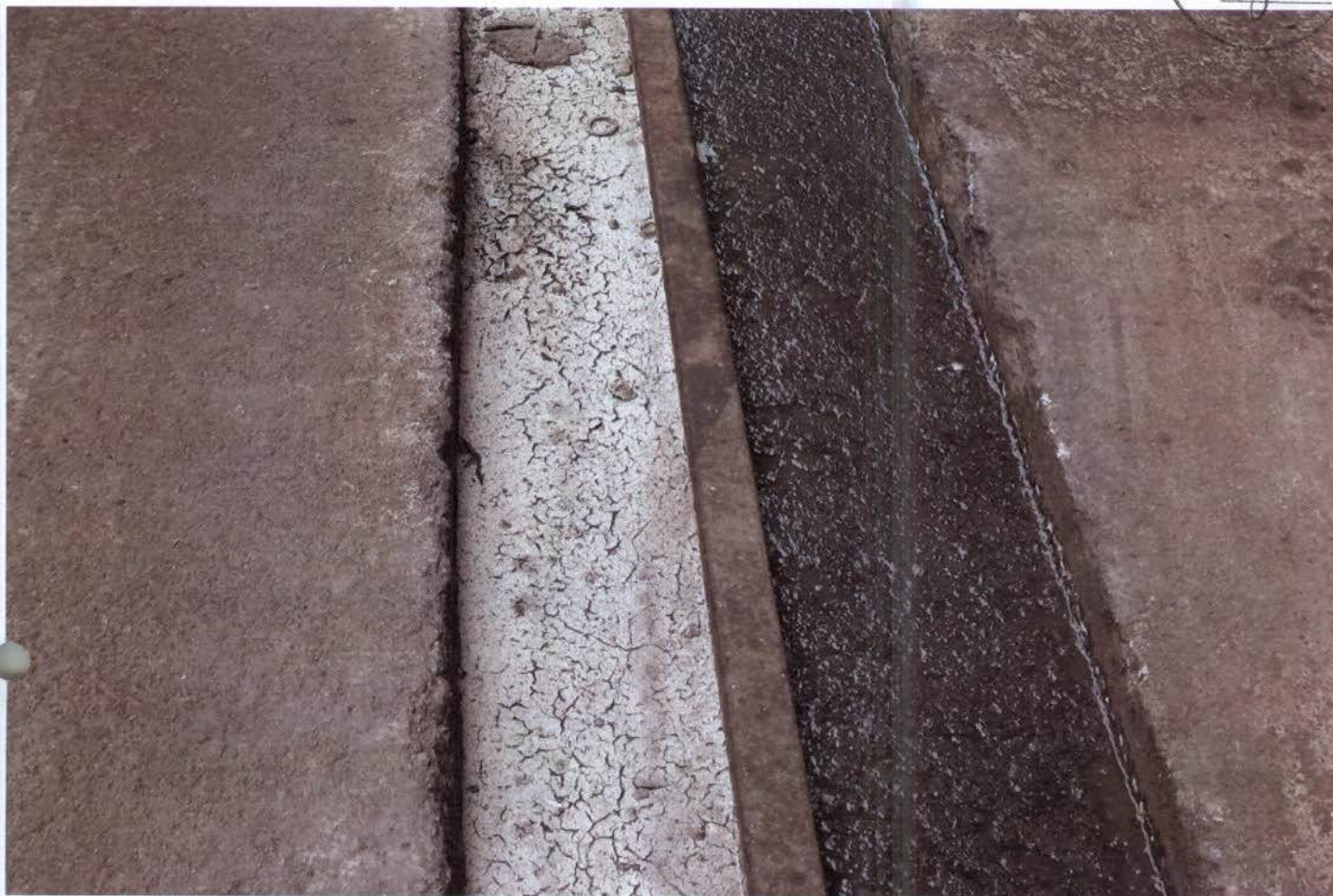
Figura 20: Acúmulo de substância em fermentação nas canaletas de drenagem.
