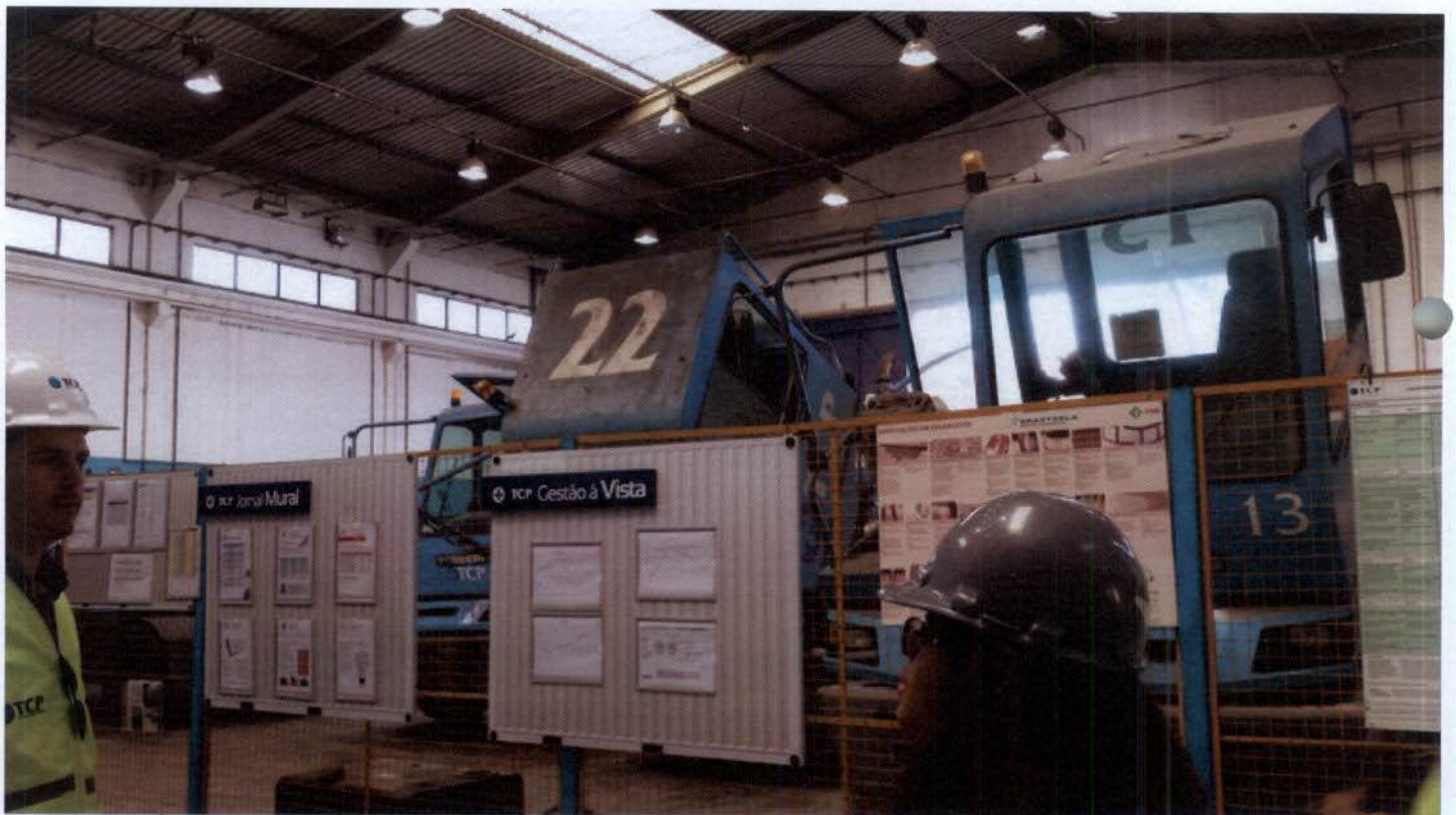
Figura 35: Área de manutenção TCP.
