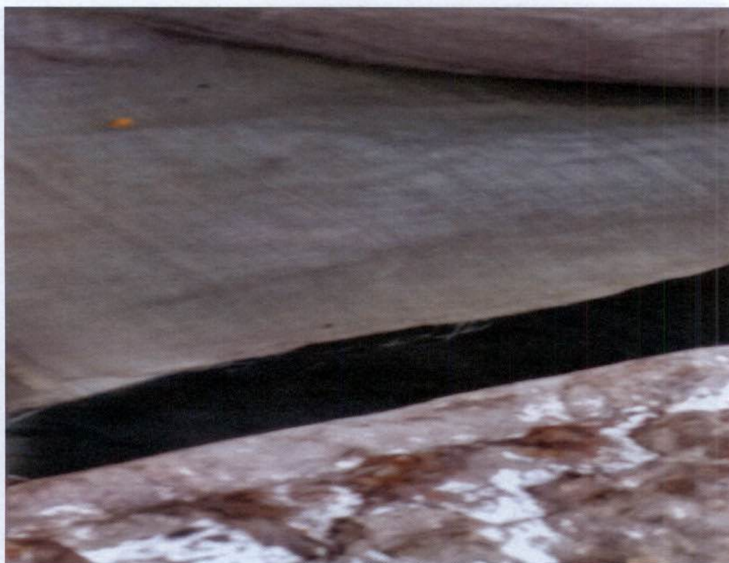
Figura 31: Serrapilheira solta, permitindo que o material particulado caia na água.
