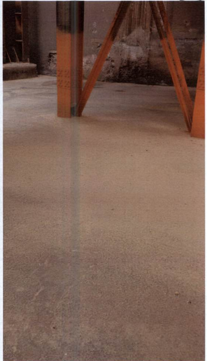
Figura 25: Parte mais antiga do porto onde observa-se acúmulo de resíduos de granéis sólidos.
