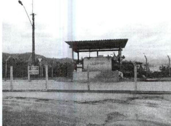
Figura 45 - Tanque de armazenamento de diesel
