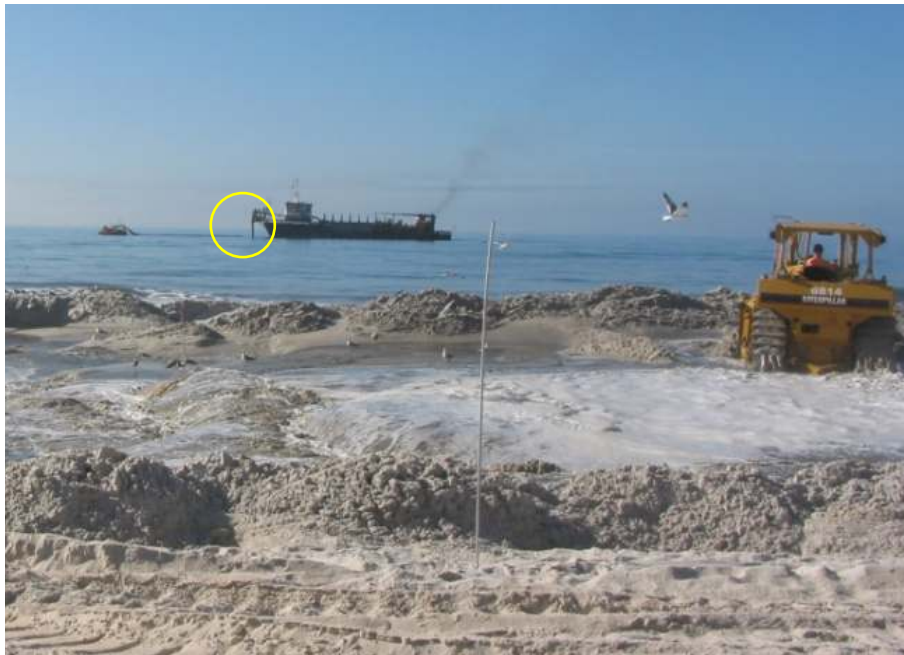
Figura 633. Ilustração de equipamento de dragagem com cisterna e sistema de bombeamento acoplado a dutos. No detalhe, em amarelo, o ponto de acoplamento com a linha de recalque. Depois da transferência, os sedimentos são espalhados e nivelados por máquinas.
