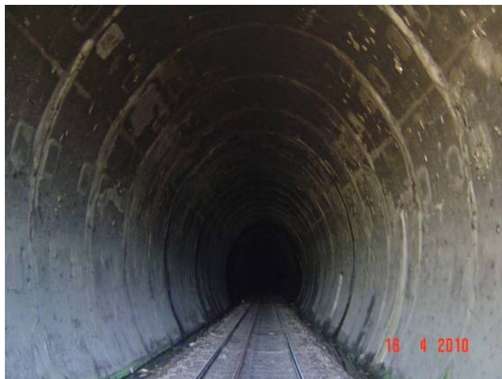
Foto 9.3.7.3-3: Aspecto geral do desemboque do túnel do Ramal Ferroviário Conceiçãozinha na região do Sítio Santa Rita. Por cerca de 50 m de extensão o trecho do túnel é revestido com concreto pré-moldado em arco, e tem sua continuidade escavada diretamente no maciço rochoso. Tais situações, aliada às feições de quebra de relevo verificadas na porção inferior da escarpa da Serra do Quilombo, onde a estrutura encontra-se instalada, sugere a presença de um corpo de tálus. Porção continental do Município de Santos, nas proximidades da ADA.
