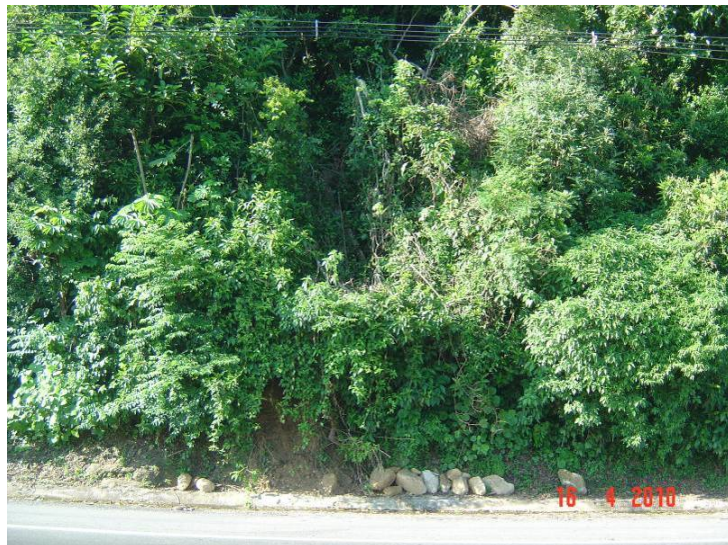
Foto 9.3.7.3-1: Vista de um escorregamento de pequenas dimensões associado à instabilidade da porção de um corpo de tálus identificado na vertente noroeste da Serra do Quilombo, lateralmente à Rodovia Cônego Domênico Rangoni. Tombamento e queda de árvores, e ocorrência de diversos blocos rolados. Porção continental do Município de Santos, na AID.
