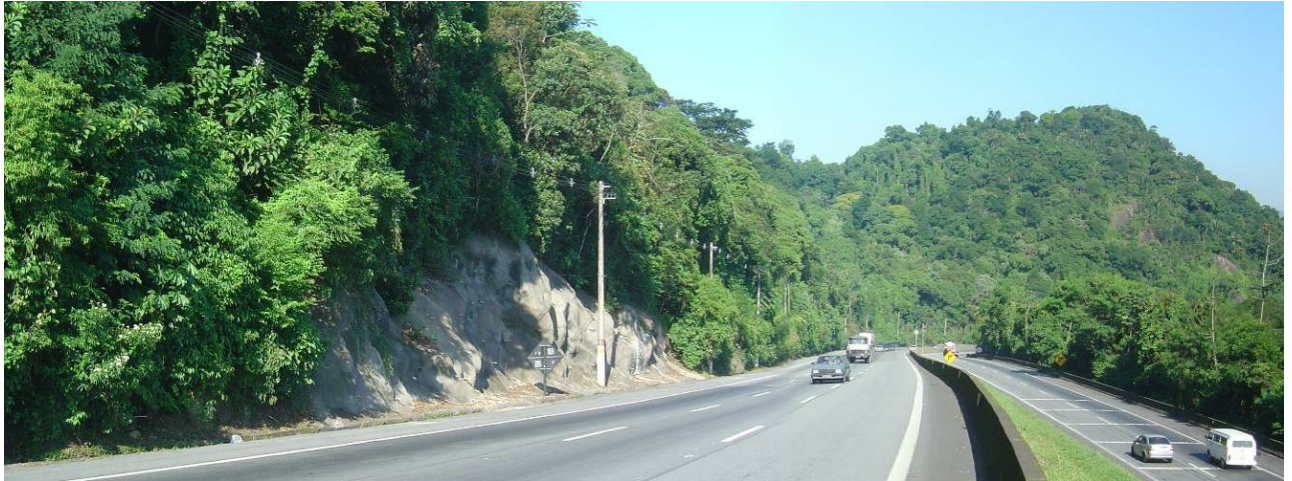
Foto 9.3.5.2-10: Vista da vertente norte da Serra do Quilombo, onde são reconhecidos corpos de tálus por grandes extensões. Obras de contenção implantada na encosta visando conter movimentos de rastejo associados com escorregamentos. Porção continental do Município de Santos.
