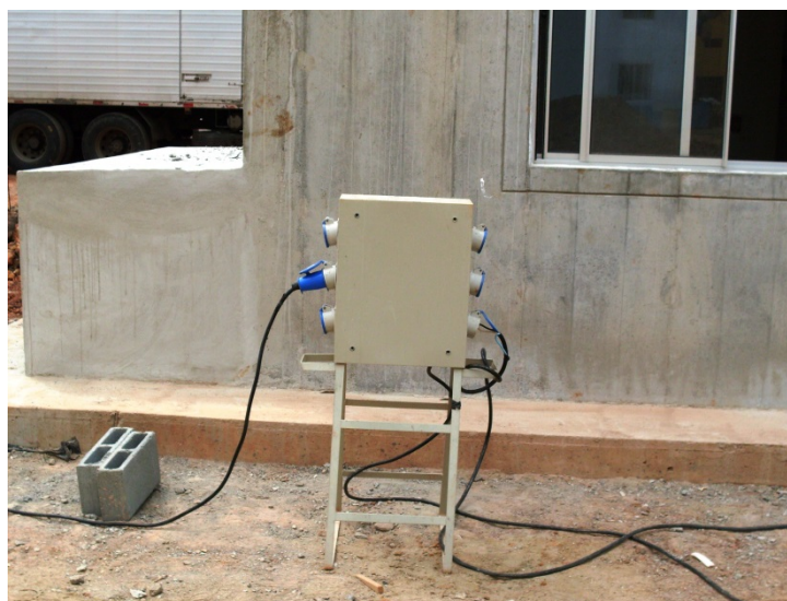
FIGURA 2.3-47– Quadro móvel para ligação dos equipamentos.
