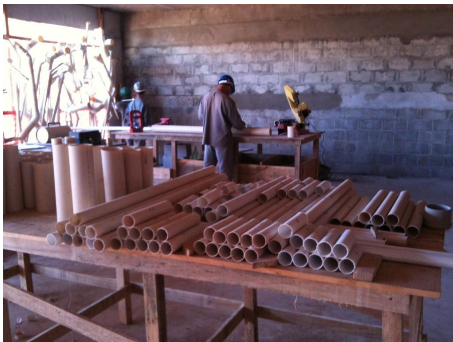
FIGURA 2.3-30 – Central de produção de kit's: bancada para corte e montagem de kit para instalações.
