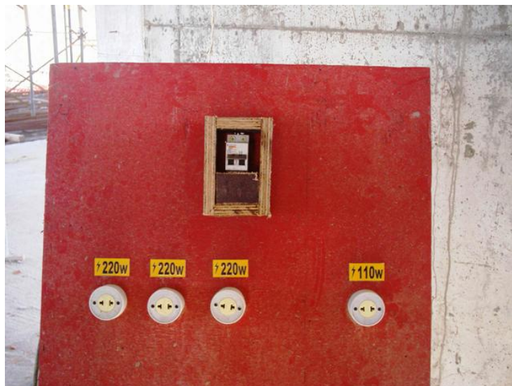
FIGURA 2.3-48– Identificação do quadro de tomadas.
