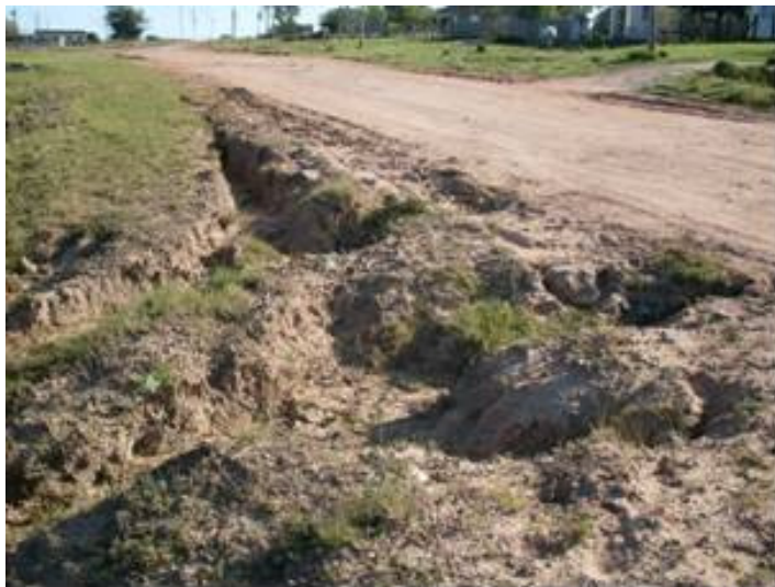
Figura 89. Erosão da estrada por água de chuva UTM 22L 273759/6400063.
