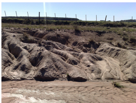
Figura 49. processo erosivo em desenvolvimento.
