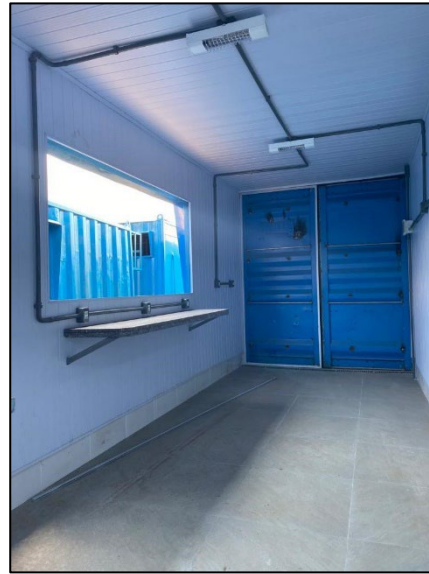
Figura II.10.4-7 - Ambulatório instalado em container (Instituto Amares).
