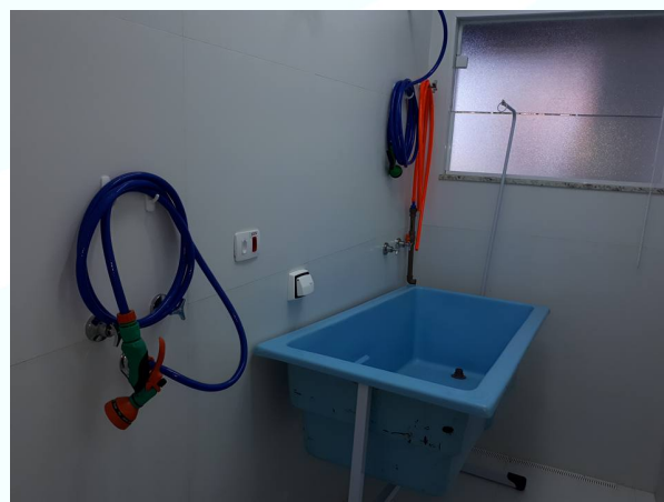
FIGURA 9: Sala de descontaminação.
