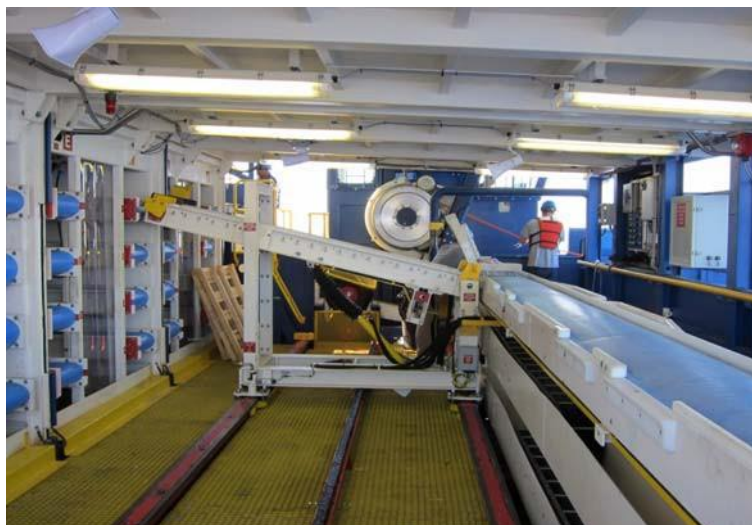
Figura II.3.4.1-5 - Sistema de esteiras transportadoras no convés de lançamento dos nódulos Z700.
