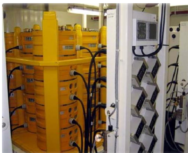
Figura II.3.4.2-1 - Estação de transferência de dados e recarga de baterias do nódulo Z3000.
